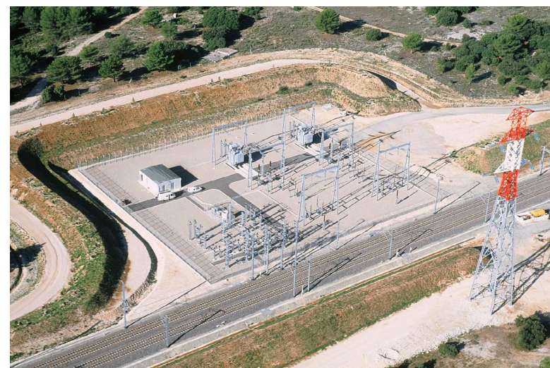
LGV Méditerranée - Sous-station de Cabriès
